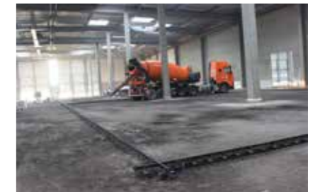
Divisão da área a pavimentar em áreas mais pequenas División del área a pavimentar/construir en áreas más pequeñas
