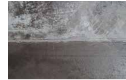
Junta logo após o acabamento da laje Junta tras el acabado de la losa
